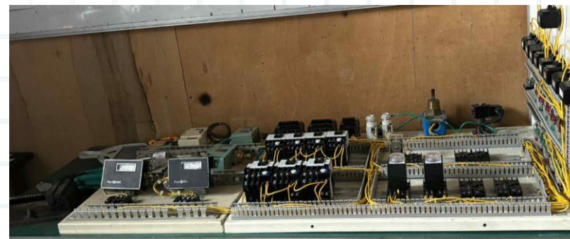
室內配線實習工廠
